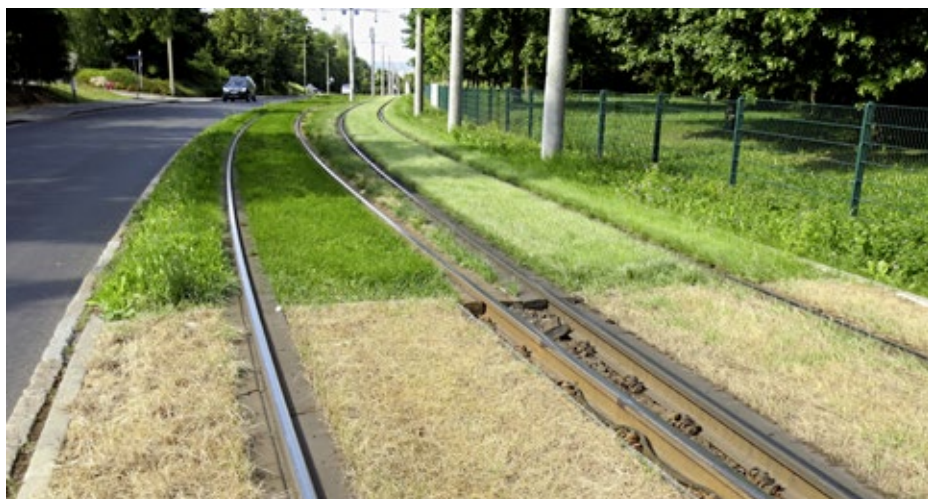
Ein Testabschnitt auf dem Netz der Dresdner Verkehrsbetriebe zeigt die Vorteile der automatischen Bewässerung: Die Vegetation übersteht auch heisse Sommer ohne regelmässigen Gärtner-Besuch.
